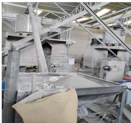
投料料斗现状
