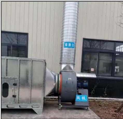
照片5 废气排放筒
