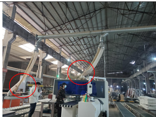
下料工序吸气口
