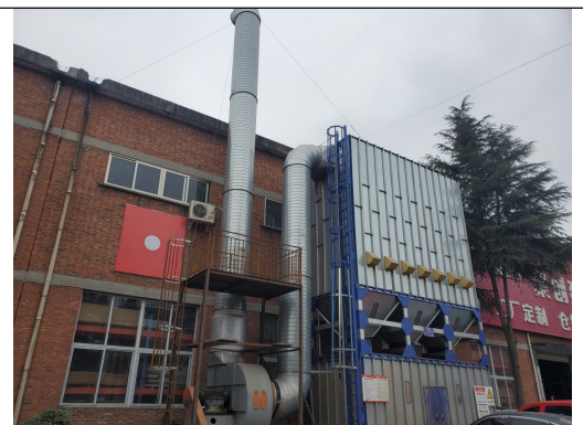
布袋除尘器+15米高排气筒
