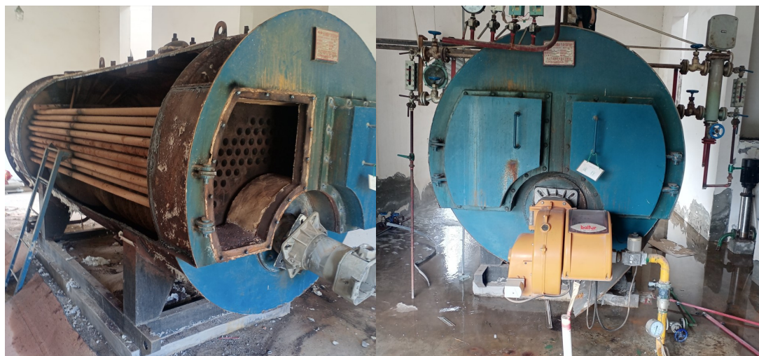
现有2台燃气锅炉现状图
