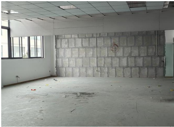
厂房内部照片
